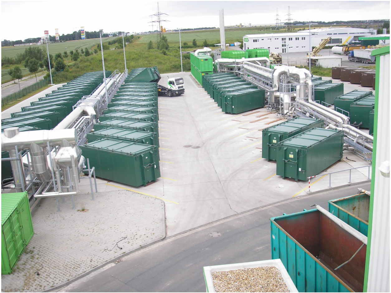
Abbildung 3: Stabilisierung in Rottecontainern sowie thermische Abluftreinigung und Biofilter
